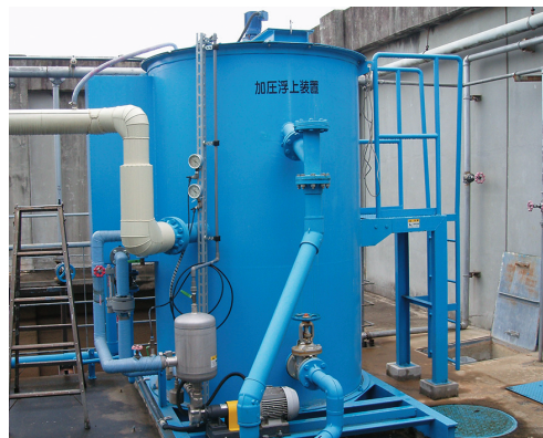
加圧浮上ユニット
